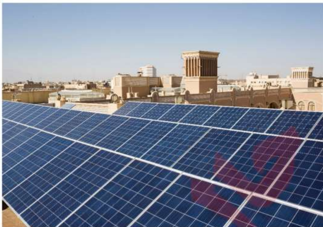
نیروگاه خورشیدی ظرفیت: ۲۰ کیلووات - محل پروژه: شهر یزد، استان یزد - زمان اتصال به شبکه: ۱۳۹۵ - مجری: شرکت دادمان
