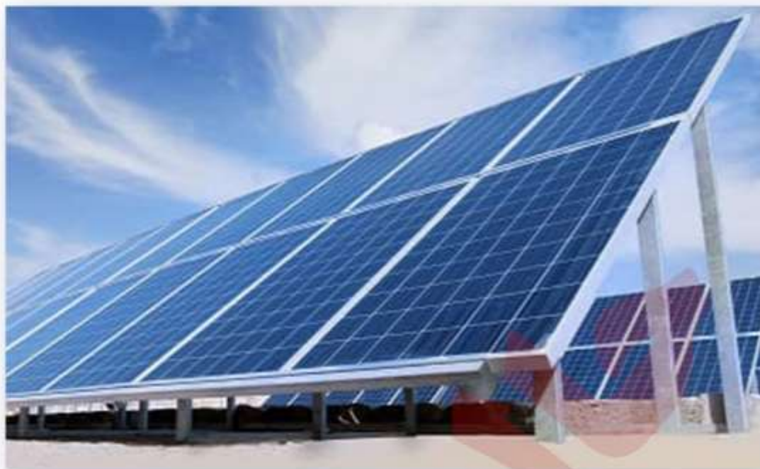
نیروکاه خورشیدی ۳۰ کیلوواتی - محل اجرا: پست ۴۰۰ کیلووات شرکت برق منطقه ای یزد - سال اجرا: ۱۳۹۳ - مجری: شرکت نیروپارس یزد
